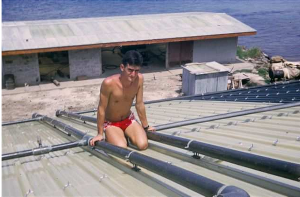
Pose de la tuyauterie d'arrosage du toit de l'abri Pantz (Olivier Verrier)
