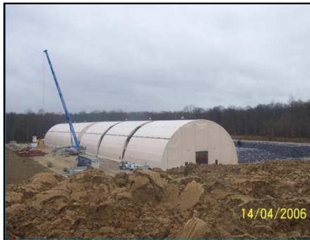
Figure 2 : Centre de stockage des TFA.
